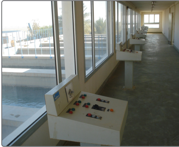
صورة (5) وحدة الترشيح (الفلاتر) من الداخل
