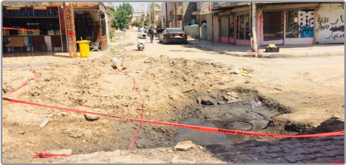
الصورة (2) تحسف احد الشوارع الرئيسية في حي الخورنق
